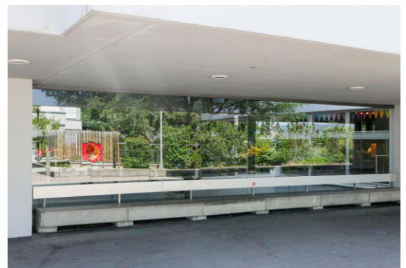
Obwohl das Gebäude mehrere Meter auskragt, sind an den Fenstern deutliche Spiegelungen zu erkennen. Schattenwurf eliminiert die Spiegelungen nicht.
