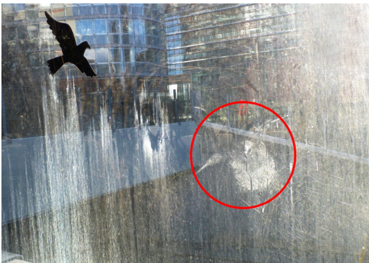
Immer wieder sind Aufprallspuren direkt neben Greifvogelsilhouetten zu finden. Auch eine seltene Scheibenreinigung bietet keinen Schutz vor Vogelkollisionen.
